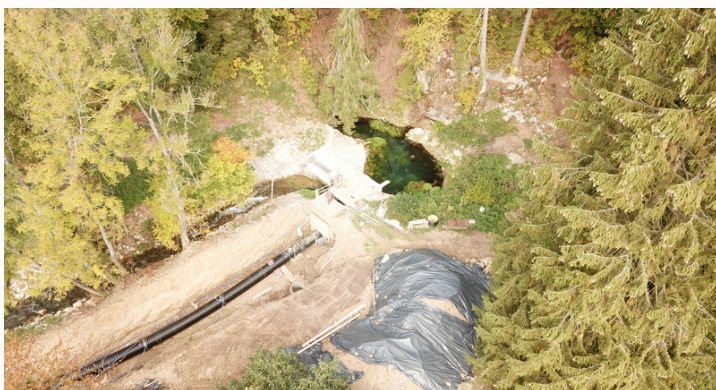
Reallabor I: Der Hybridkanal dient als Druckstollen eines Wasserkraftwerkes. @Frank GmbH
