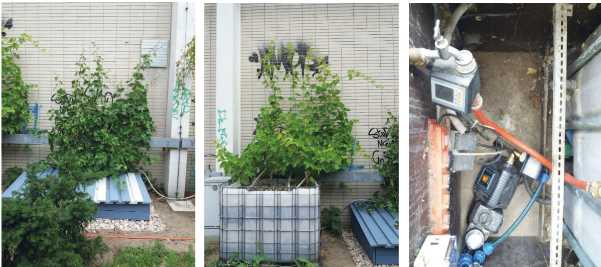
Abbildung 14 Installierte Fassadengrünlysimeter (links, mitte) und Blick auf die Bewässerungssteuerung (2019, Quelle: Nehls, TU-Berlin).
