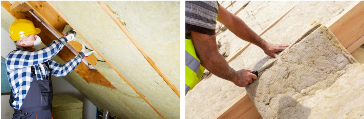
Abb. 5.10: Beispiele einer Zwischensparrendämmung von Innen und Außen (Quellen: ©artursfoto - stock.adobe.com (links), ©brizmaker-AdobeStock.com (rechts)).
